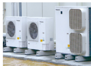
CO 2 冷媒冷凍・冷蔵システム
